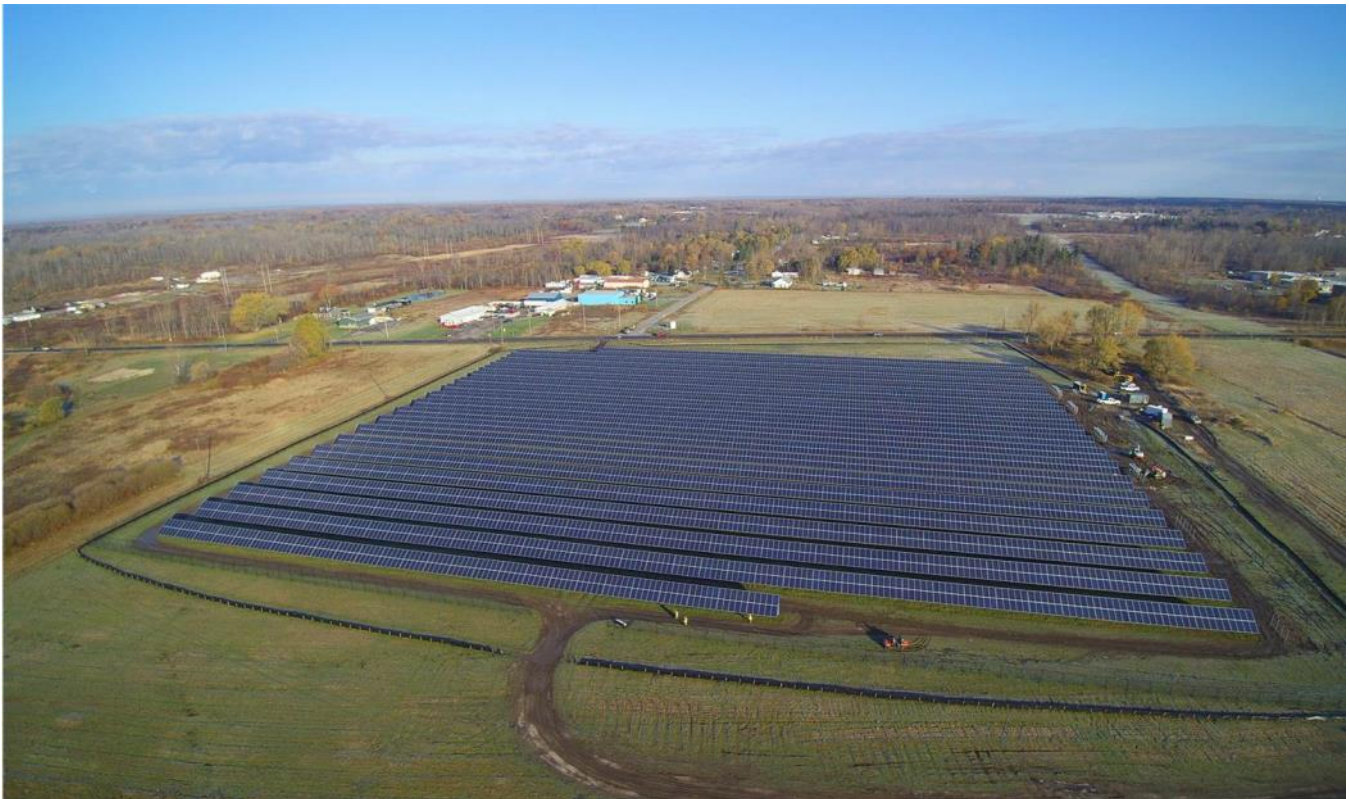
2 MW Solar Array, Alden
