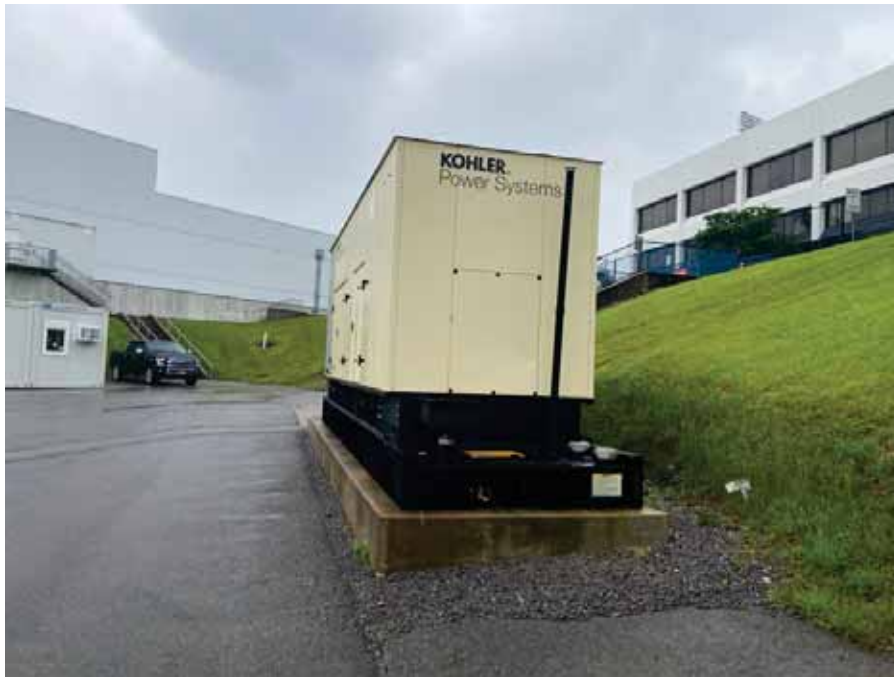
Photo 57 : 500-gallon diesel generator
